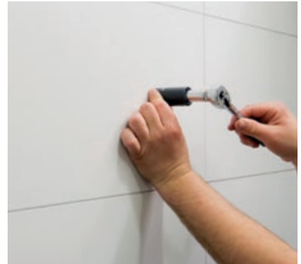
Anschlussstück an der Wand montieren.
